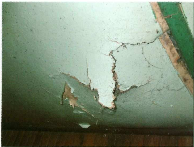
Le plafond de la "salle d'accueil" s'effondre et devient dangereux !
